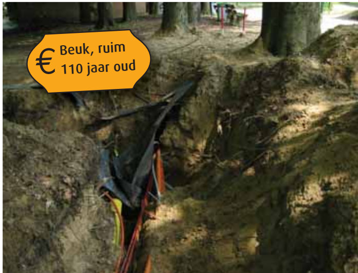
Forse wortelschade door graafwerkzaamheden bij een beuk.
